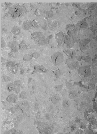
Corrosione localizzata dovuta ad elevato tenore di sale
