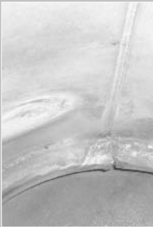
Surriscaldamento, cricca da corrosione
