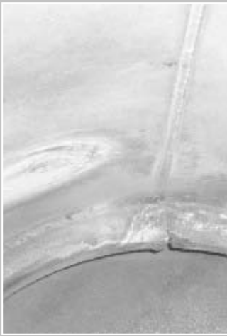
Surriscaldamento, cricca da corrosione
