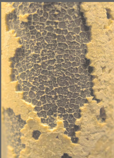
Kalkausfällung im Heizkessel
