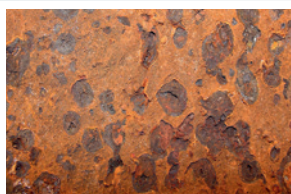
Korrosion eines Heizkessels
